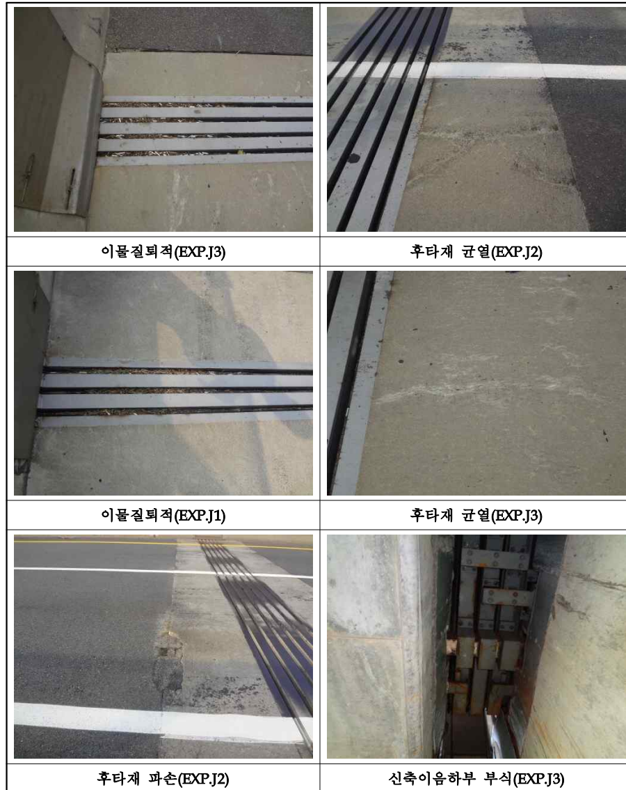
【사진 3.2.15】 신축이음장치 손상현황(대구)
