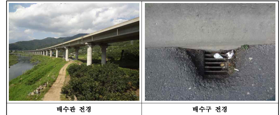
【사진 3.2.19】 배수구 및 배수관 전경(대구)
