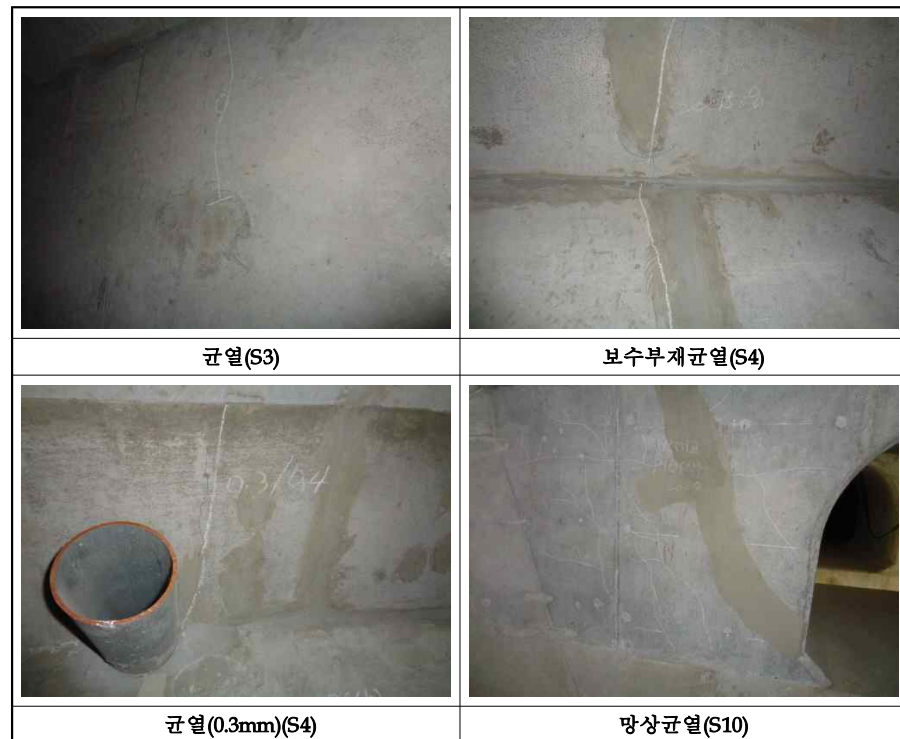
【사진 3.2.6】격벽 손상현황(대구)
