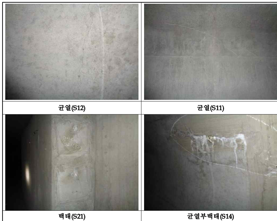
【사진 3.3.4】거더 내부 손상현황(부산)
