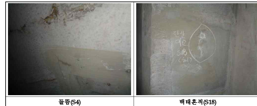
【사진 3.3.4】거더 내부 손상현황(부산,계속)
