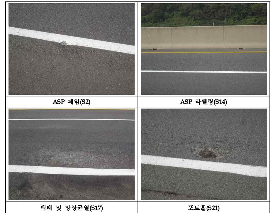
【사진 3.2.18】 교면포장 손상현황(대구)
