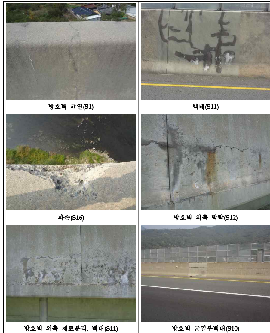
【사진 3.3.22】 난간 및 연석 손상현황(부산)
