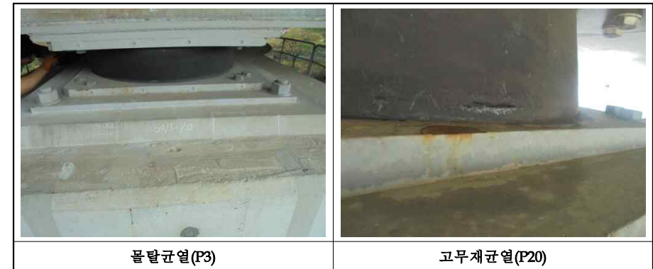
【사진 3.3.13】 교량받침 손상현황(부산)
