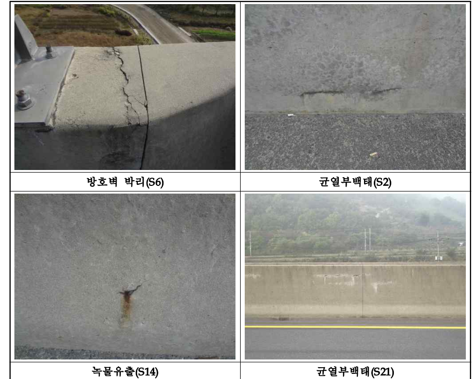
【사진 3.2.21】 난간 및 연석 손상현황(대구)
