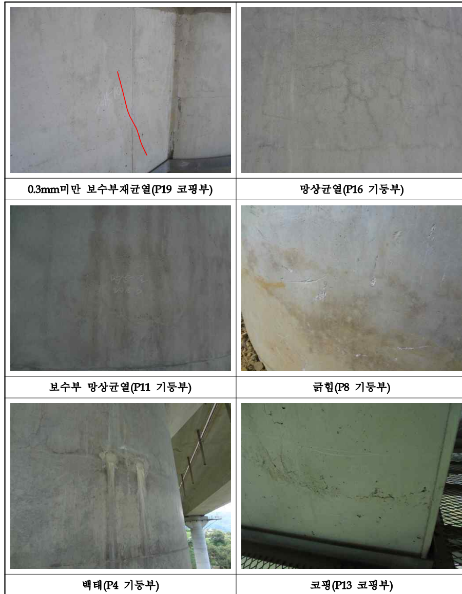
【사진 3.2.10】 교각 손상현황(대구,계속)
