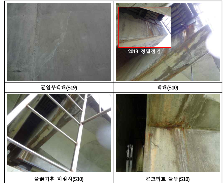
【사진 3.3.2】 거더외부 손상현황(부산, 계속)
