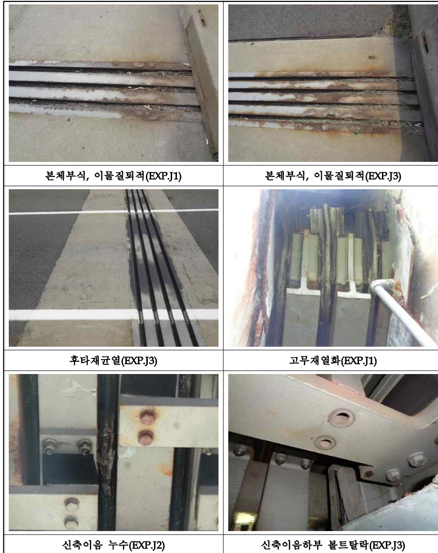
【사진 3.3.15】 신축이음장치 손상현황(부산)
