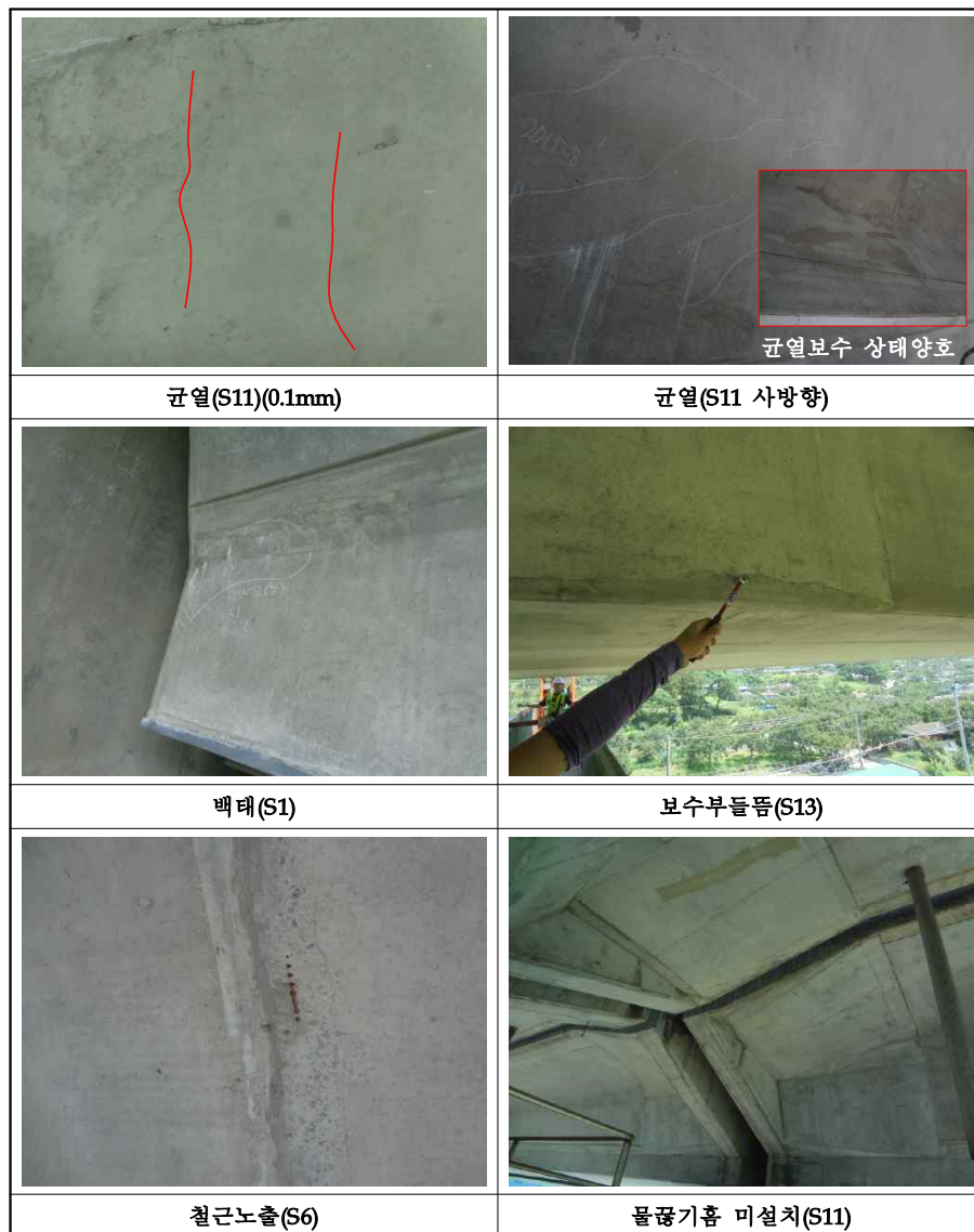
【사진 3.2.2】 거더외부 손상현황(대구)
