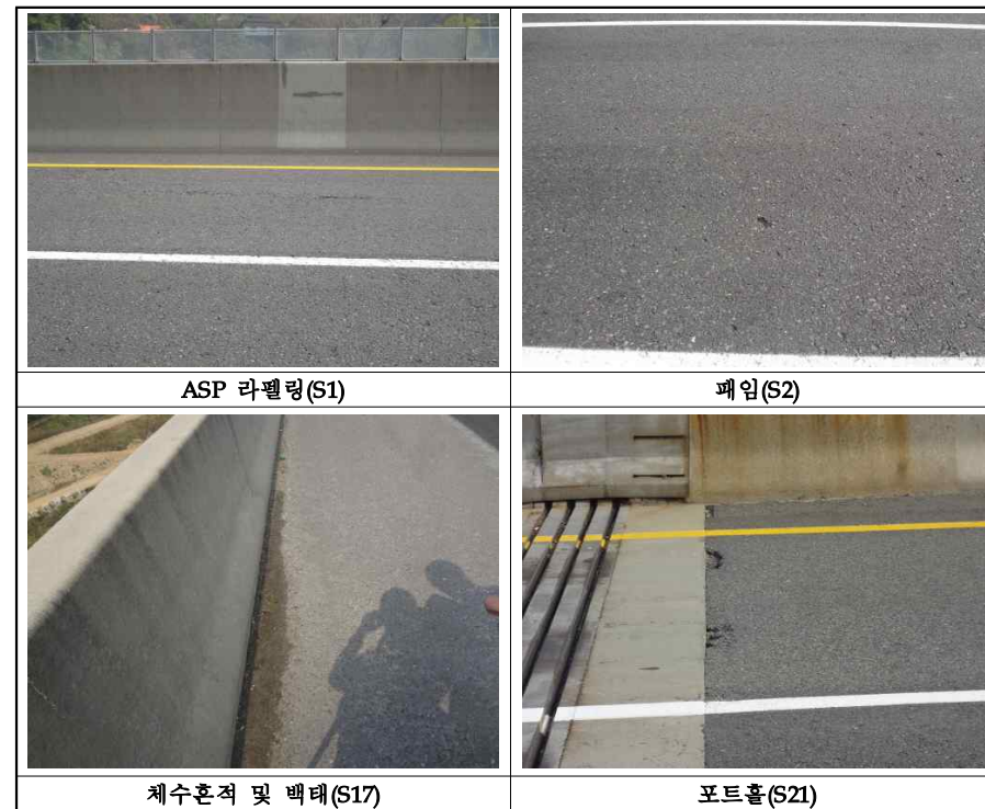
【사진 3.3.18】 교면포장 손상현황(부산)
