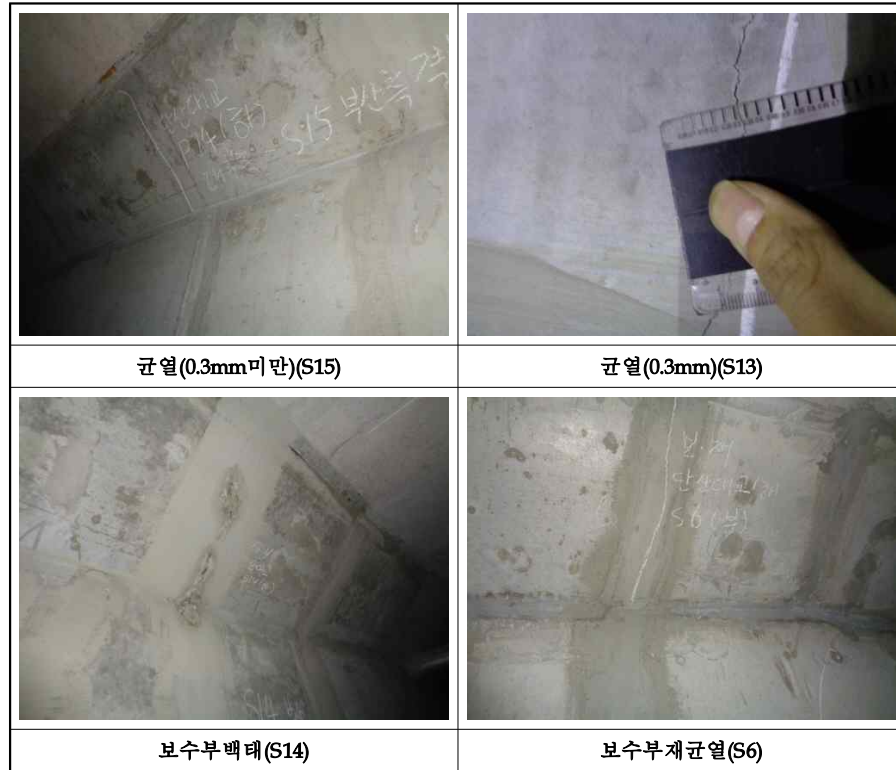
【사진 3.3.6】 벽면 손상현황(부산)
