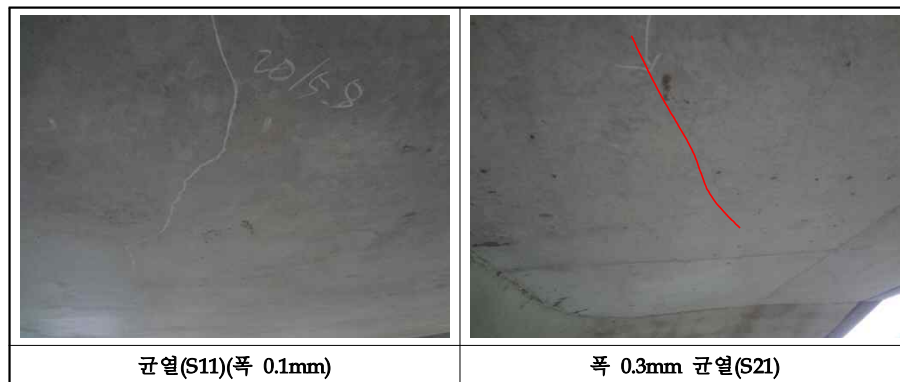
【사진 3.3.2】 거더외부 손상현황(부산)
