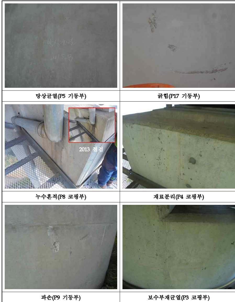
【사진 3.3.10】 교각 손상현황(부산,계속)
